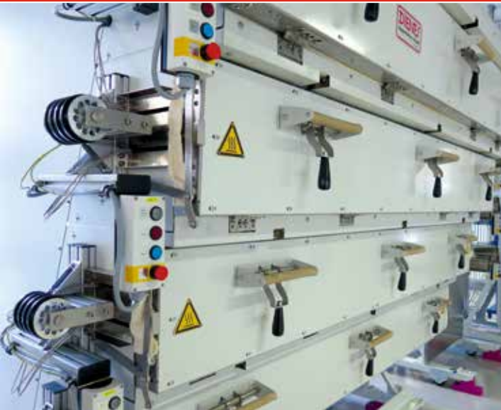
Stabilisierungsanlage im ITCF
